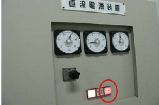
（状態表示ランプの誤作動・故障ランプの異常点灯）
