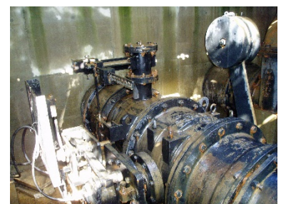
5号支線吐水槽緊急遮断弁
