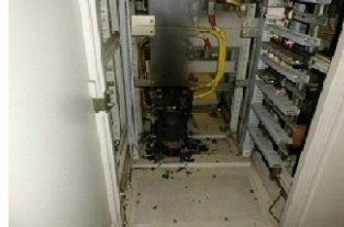
（スイッチ誤作動による電動機始動器の焼損）
