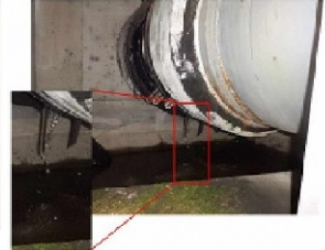
（継手部から漏水）
