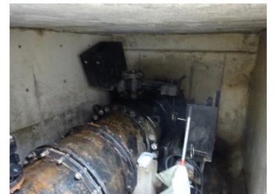
北幹線(伊方町九町)緊急遮断弁
