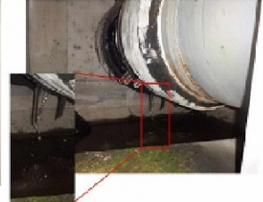
(継手部から漏水)
