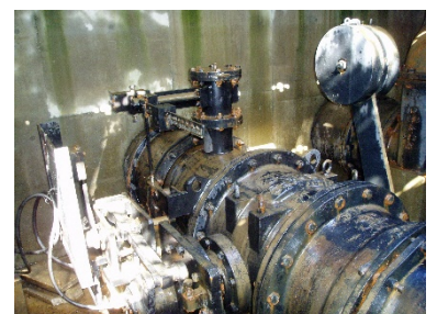
5号支線吐水槽緊急遮断弁
