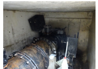
北幹線(伊方町九町)緊急遮断弁
